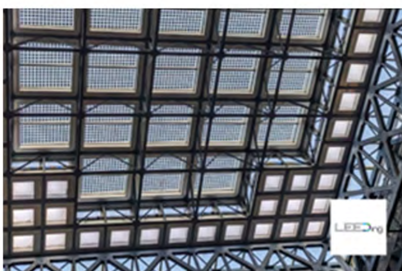
Pannelli fotovoltaici Onyx
